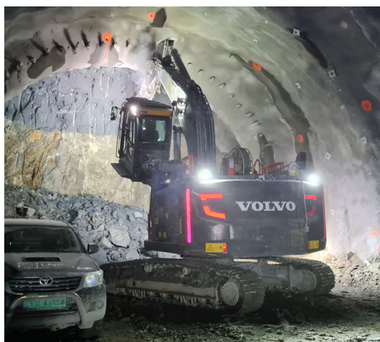
Før jul 2022 ble det påtruffet løse masser i Bergåstunnelen
