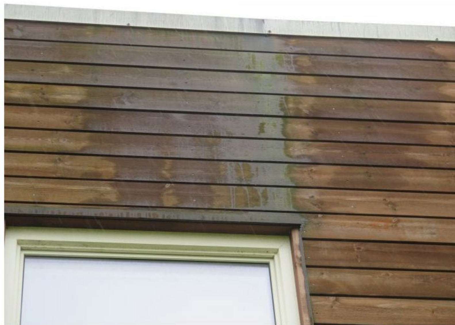
Mye fuktighet på veggen fører til soppvekst og misfarging. Særlig nye hus er utsatt. (Foto: Mycoteam)
