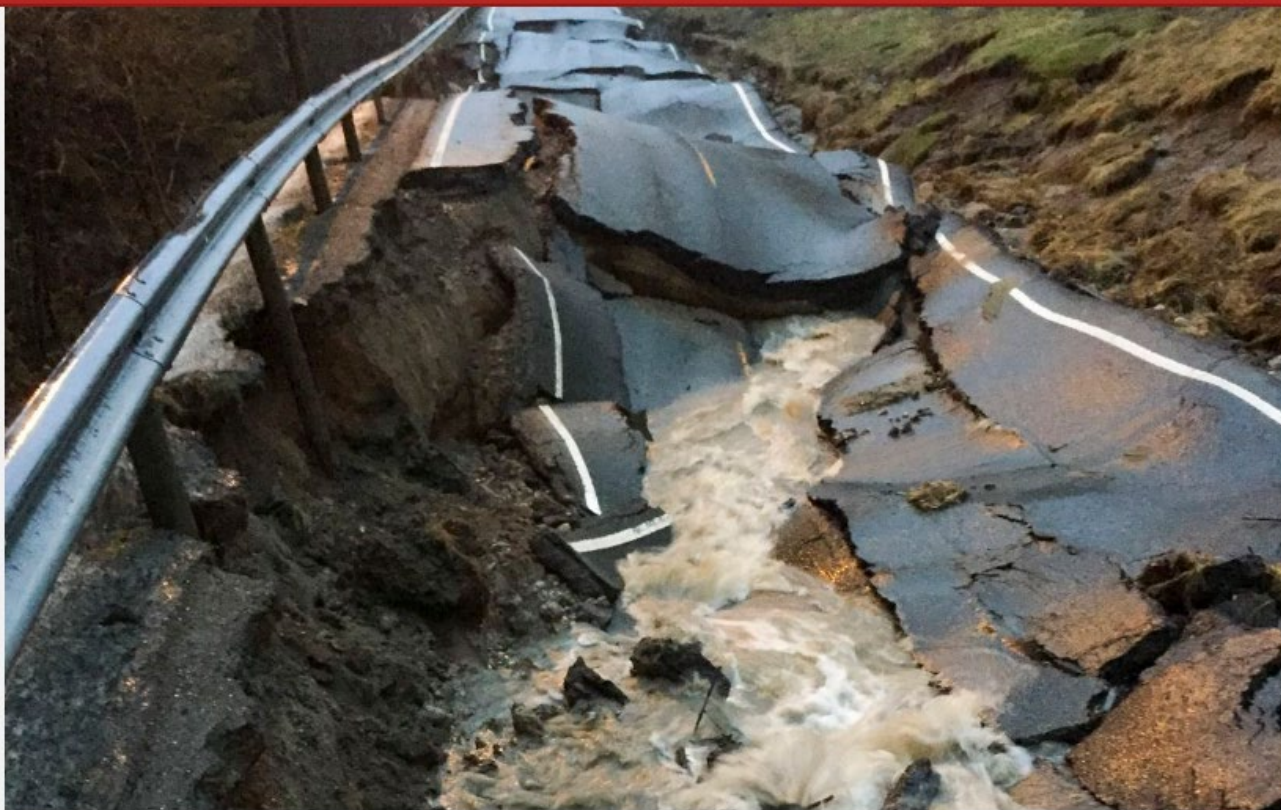
E39 ved Vinjeøra i Trøndelag ble i januar stengt på grunn av skader som en følge av ekstremværet Gyda. De siste ti årene har slike hendelser forekommet hyppigere enn før, ifølge Finans Norge. Foto: Svein Stavås / NTB
